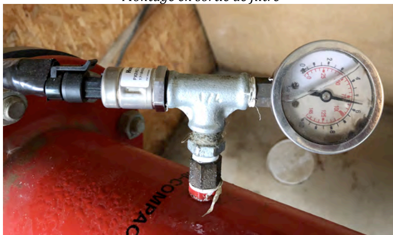
Montage en sortie de filtre
