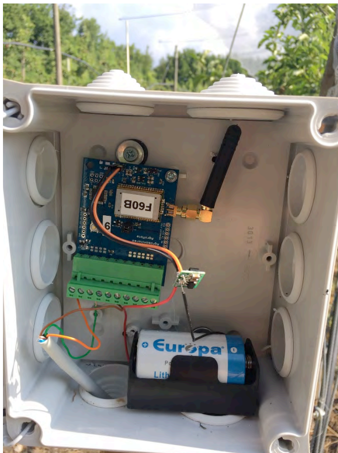
L'intérieur d'un boîtier de 1 ère génération
